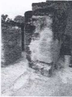
Acrópolis del Norte, estructura 5D-22. Cámara central, jamba oeste. Finalización de las actividades de restauración arquitectónica.
