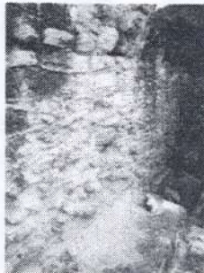
Acrópolis del Norte, estructura 5D-22. Cámara norte, muro interior edificio, lado norte. Proceso y terminación de las actividades de conservación arquitectónica.
